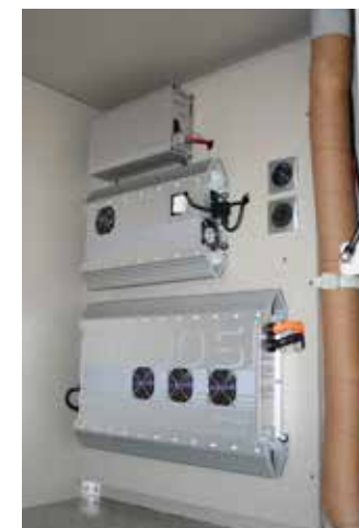
Wartungsfreundlich: Die Anordnung der Technik ist durchdacht. Kabel und Schläuche sind sauber verlegt.
